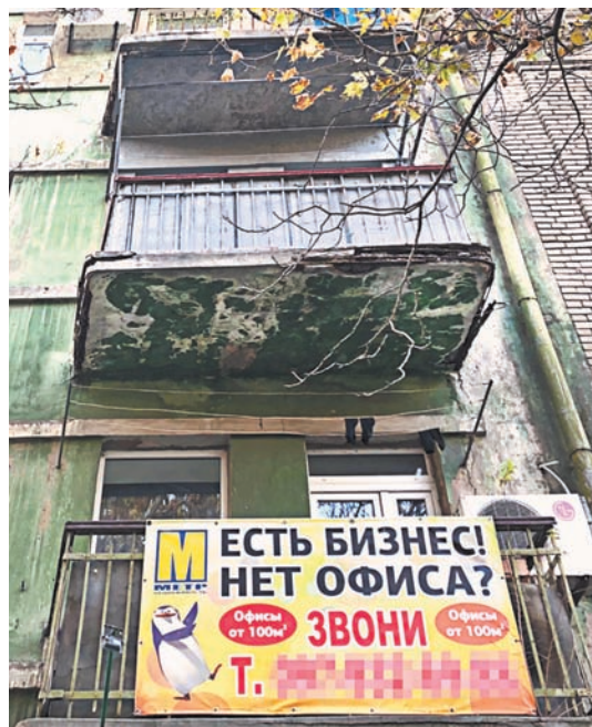
Износ застройки и инфраструктуры города, по заявлению мэра, уже критический — 80%.
